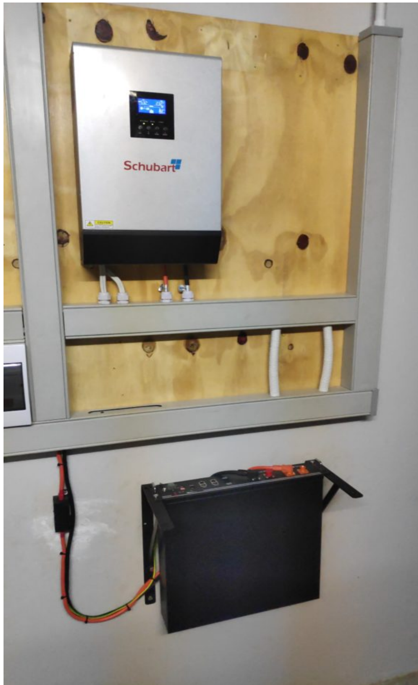
De batterij met inverter
