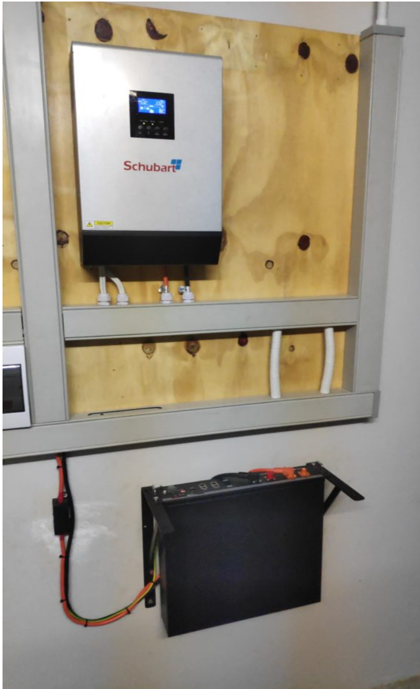
De batterij met inverter
